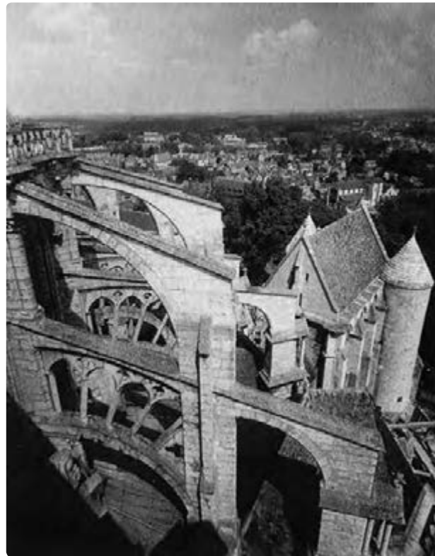
تصویر ۳۴- حایل‌های توخالی دیوارها در معماری گوتیک
