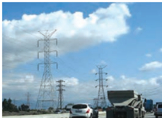
شکل ۳-۵- انتقال انرژی الکتریکی توسط دکل ها
